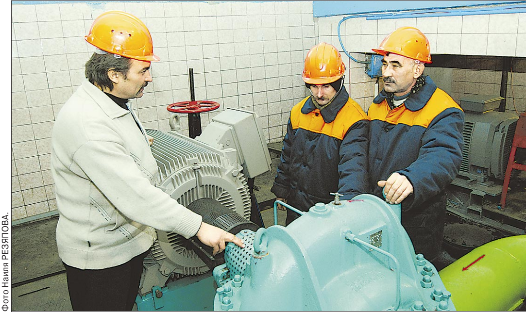
Новое оборудование позволяет Ишимбайскому водоканалу заметно снизить энергопотребление.
